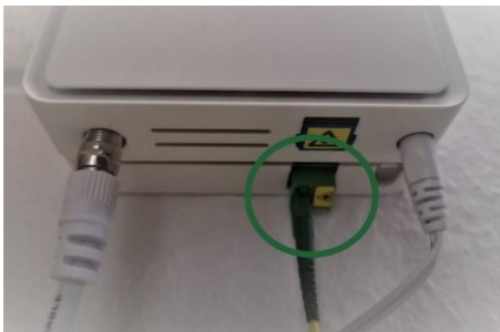
Abb. 8: Eingang für das Glasfaser am Fibertwist
