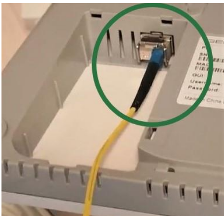
Abb. 6: Glasfaserkabel im SFP
